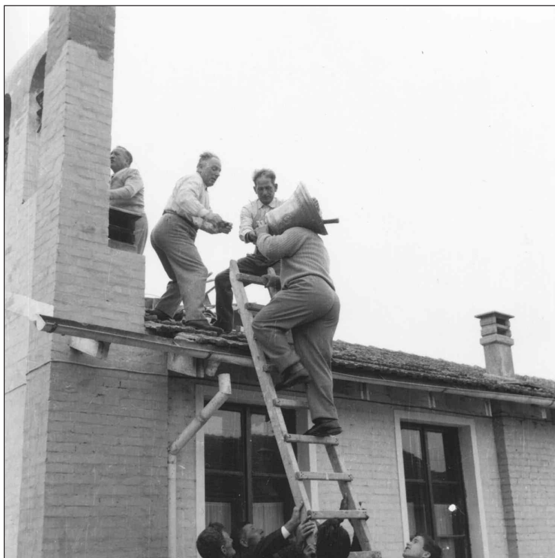
Villaggio San Marco. Si installano le nuove campane sul campaniletto della chiesetta del Villaggio
